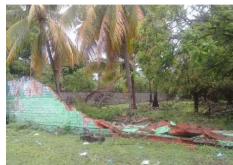
Muro colapsado en la entrada de San Luis la Herradura, departamento de La Paz. Fuente. Juanita Santamaría de la Comisión Municipal de Protección Civil de la Herradura.
